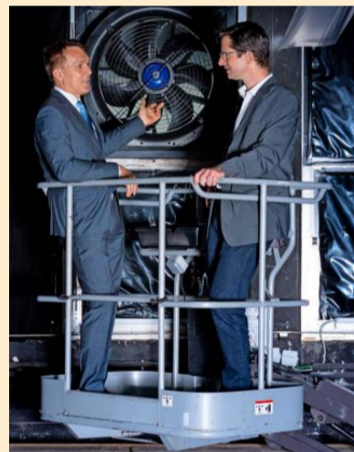
Michael Gordon (Motorwerk) und Peter Fenzl (Ziehl-Abegg, li.) in luftiger Höhe an den Ventilatoren. Foto: privat
